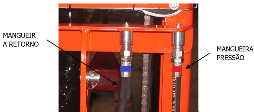
Figura 6.6 – Identificação das mangueiras hidráulicas
