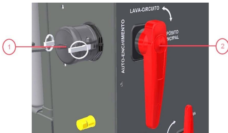
Figura 6.16 – Ex. Painel de válvulas
